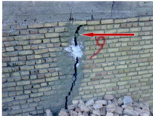
شکل ۷. ترک ایجادشده در دیوار ساختمان
